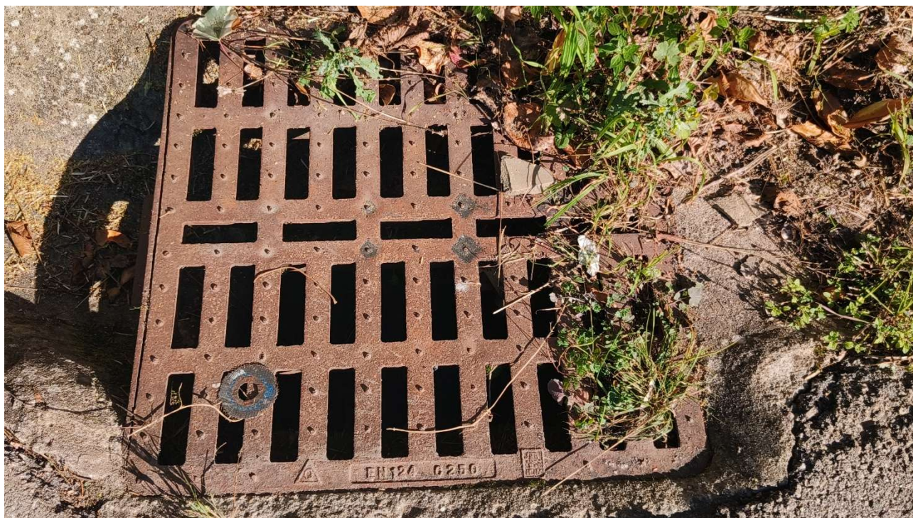
Figura 16 Caditoia a bordo carreggiata dal lato di monte
