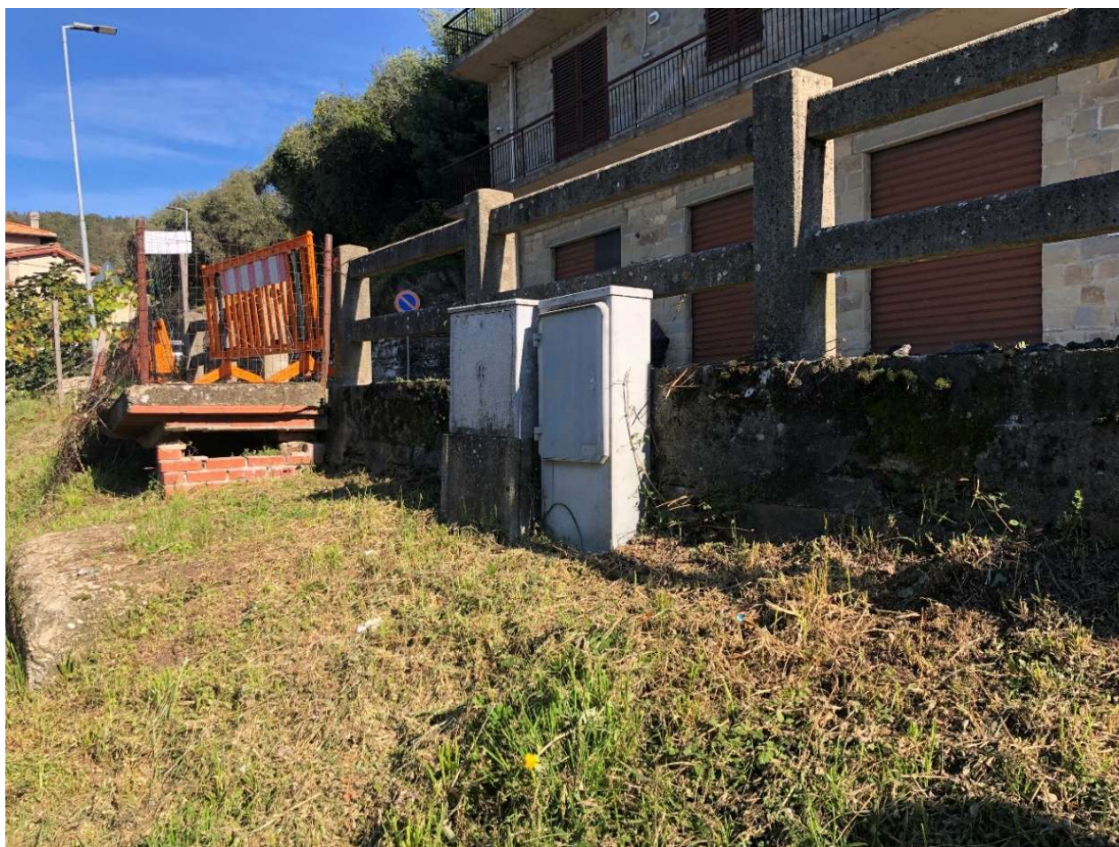
Figura 19 Armadio elettrico da spostare
